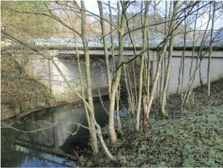
Durchlass; Ufer unterbrochen
