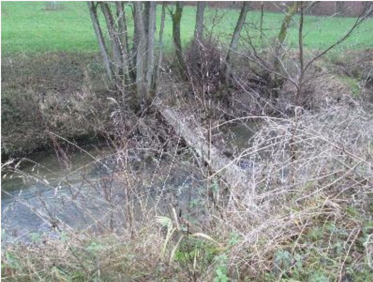
Durchlass; nicht strukturschädlich - Totholzverkläusung
