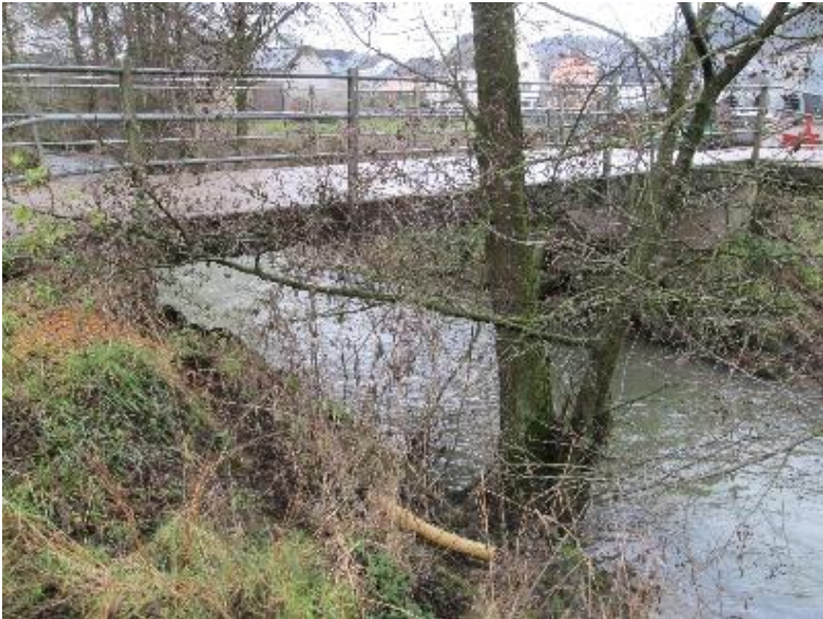
Durchlass; Ufer unterbrochen
