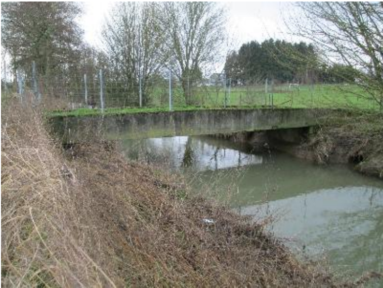
Durchlass; Ufer unterbrochen
