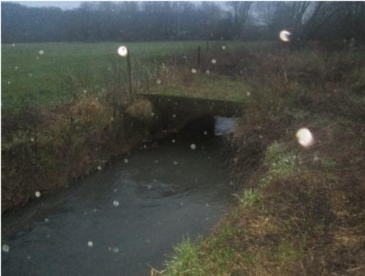
Durchlass; Ufer unterbrochen
