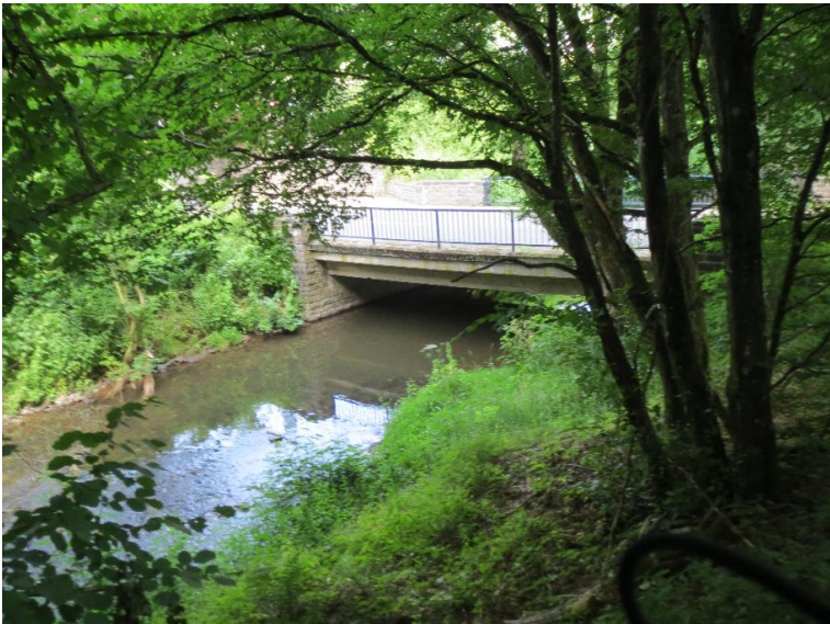
Durchlass; Ufer unterbrochen
