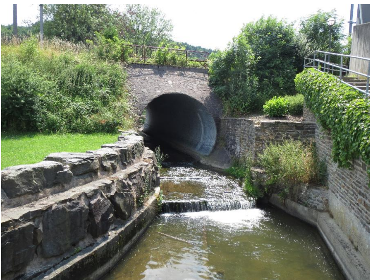
Absturz; kleiner - Durchlass; Lauf verengt
