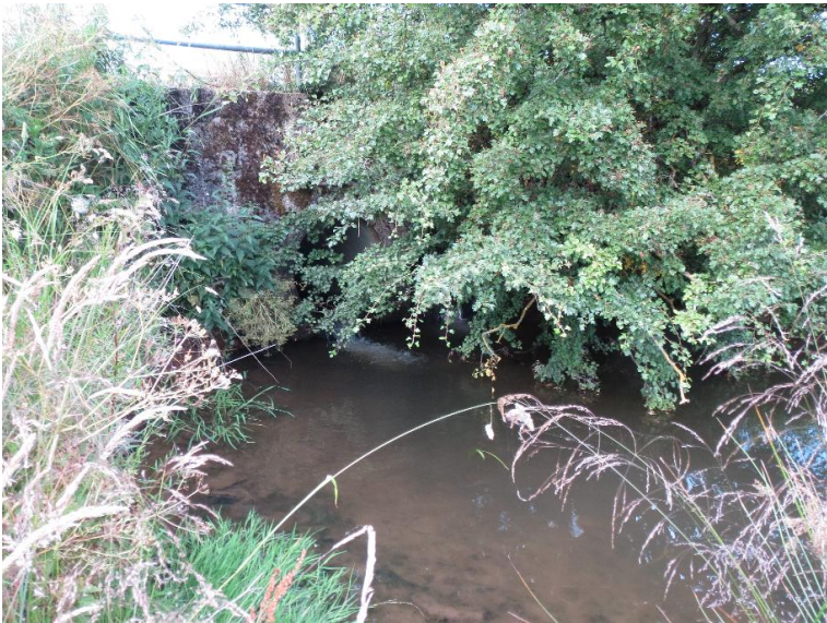
Absturz aus Verrohrung
