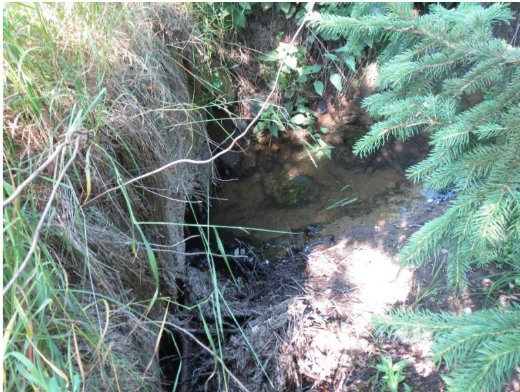
Durchlass; Ufer unterbrochen
