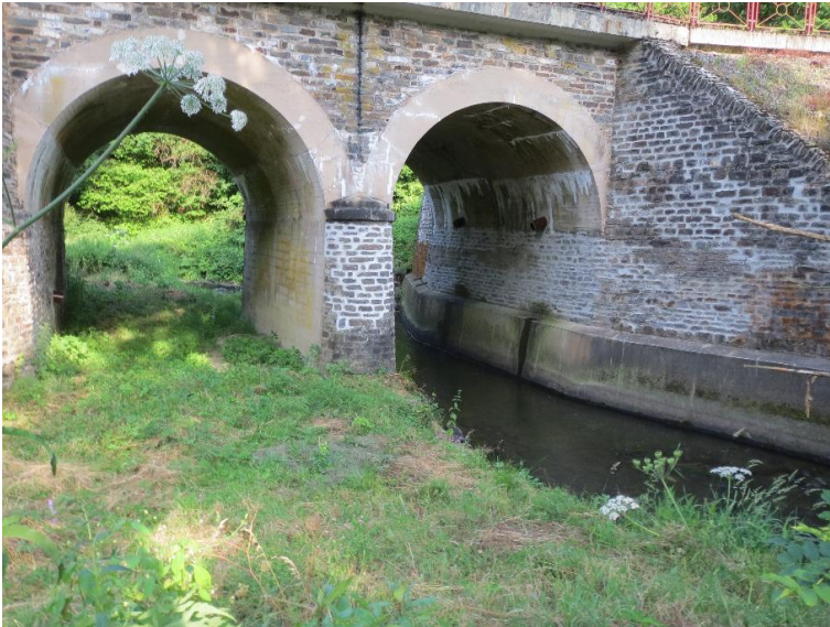
Durchlass; Ufer unterbrochen
