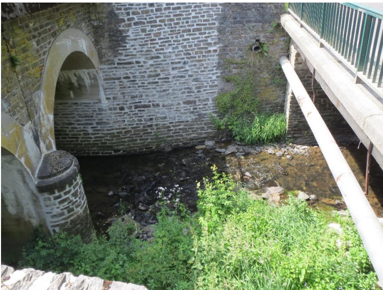
Durchlass; Ufer unterbrochen
