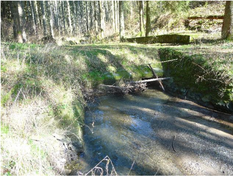
Durchlass; Lauf verengt
