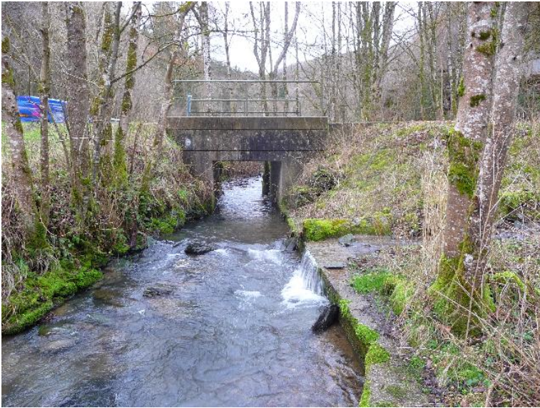
Durchlass; Lauf verengt
