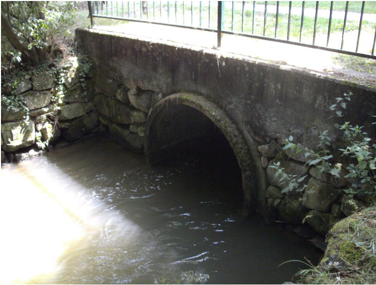
Durchlass; Lauf verengt
