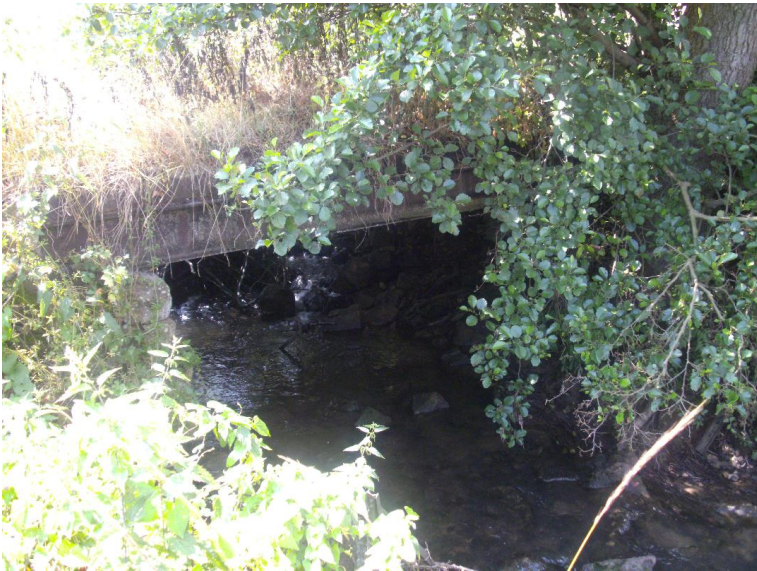
Durchlass; Ufer unterbrochen
