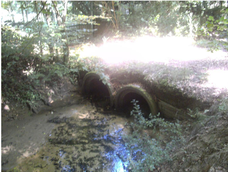
Durchlass; Lauf verengt
