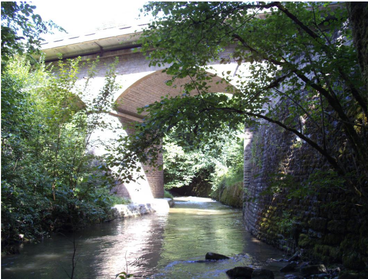
Durchlass; Lauf verengt
