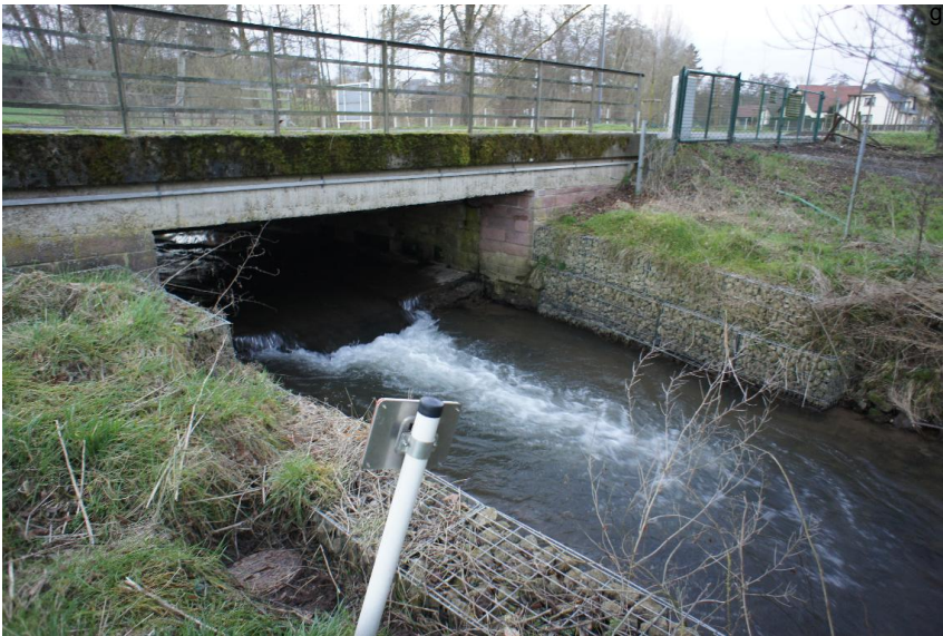
Ufersicherung - Durchlass; Ufer unterbrochen - Absturz; kleiner
