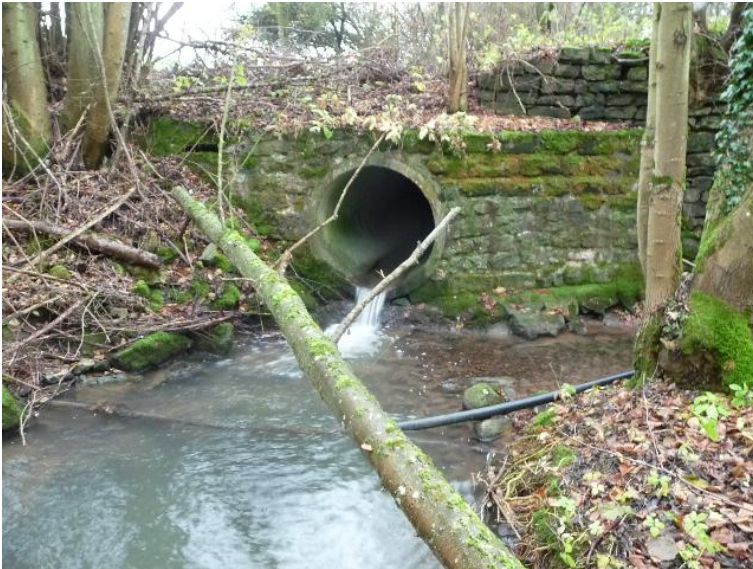
Durchlass; Lauf verengt
