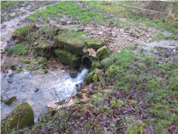
Durchlass; Lauf verengt
