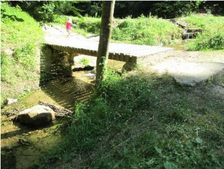
Durchlass; Ufer unterbrochen
