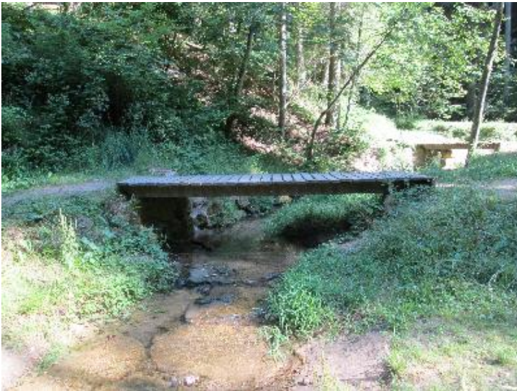
Durchlass; Ufer unterbrochen
