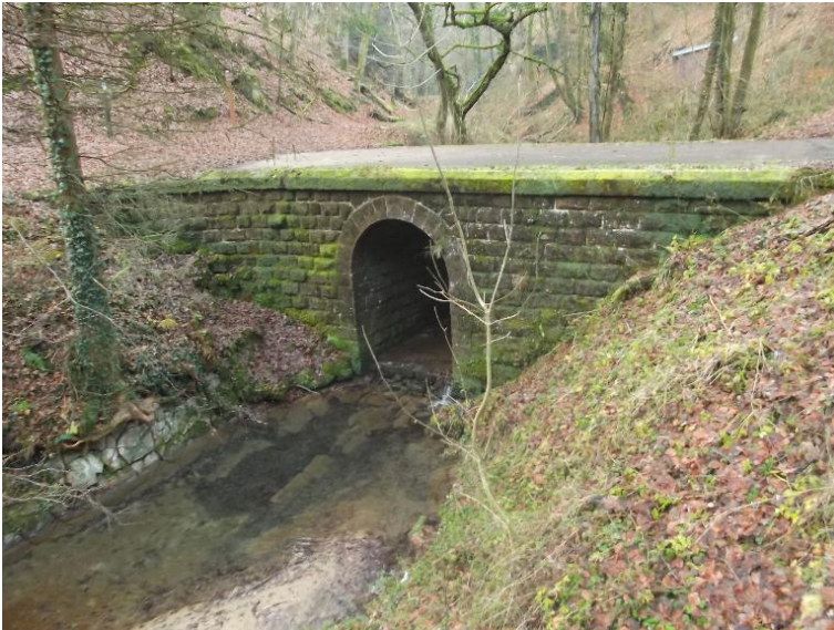
Durchlass; Lauf verengt
