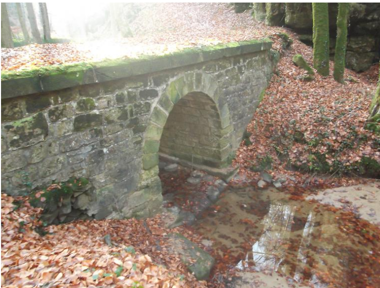
Durchlass; Lauf verengt
