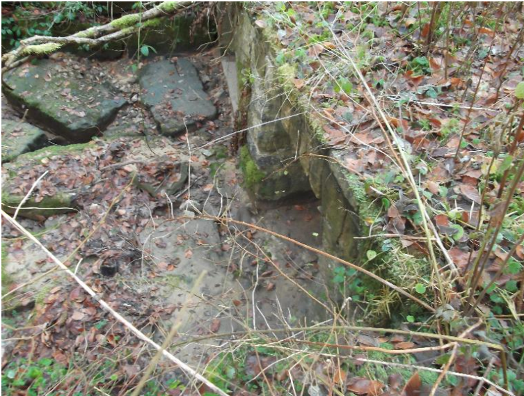
Durchlass; Lauf verengt
