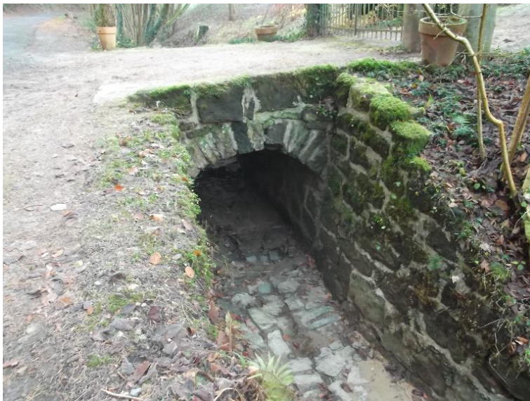
Durchlass; Lauf verengt
