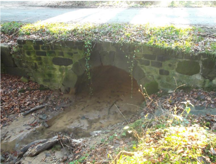
Durchlass; Lauf verengt
