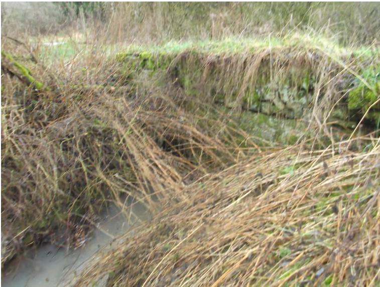
Durchlass; Lauf verengt
