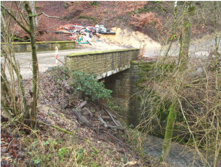
Durchlass; Lauf verengt
