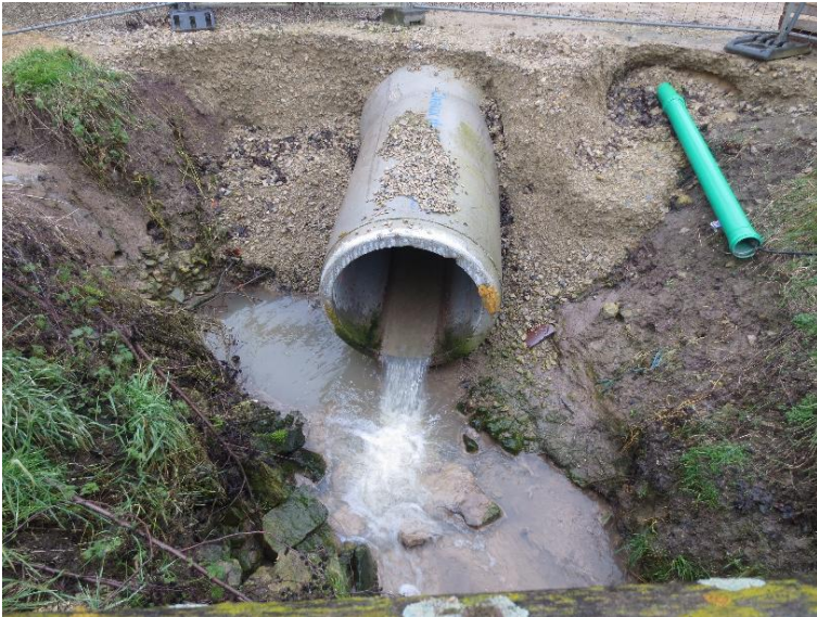
Absturz aus Verrohrung
