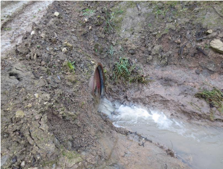
Durchlass; Lauf verengt
