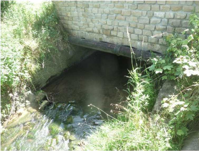
Durchlass; Ufer unterbrochen
