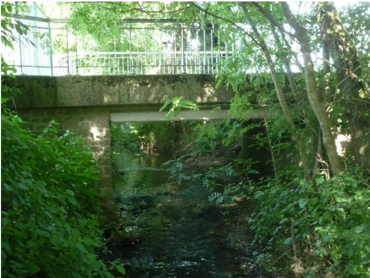
Durchlass; Ufer unterbrochen
