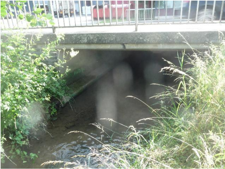
Durchlass; Ufer unterbrochen
