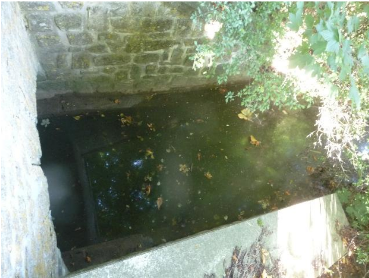
Durchlass; Ufer unterbrochen
