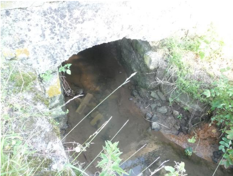
Durchlass; Ufer unterbrochen
