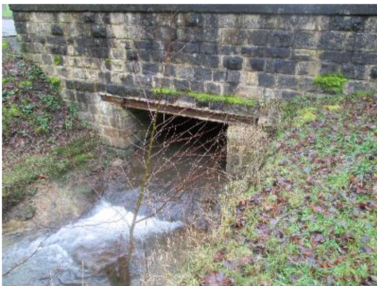
Absturz aus Verrohrung
