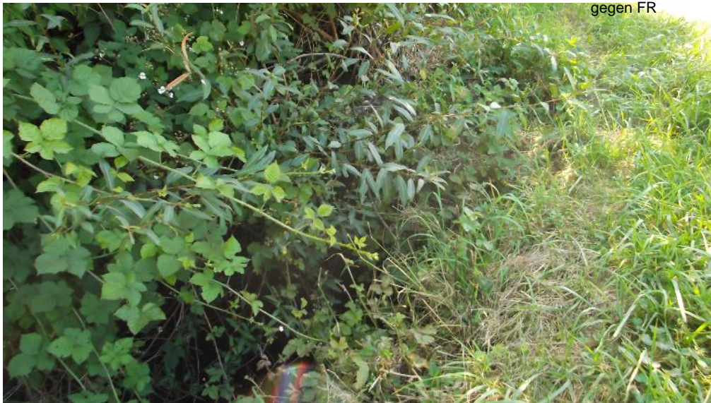
Durchlass; Lauf verengt
