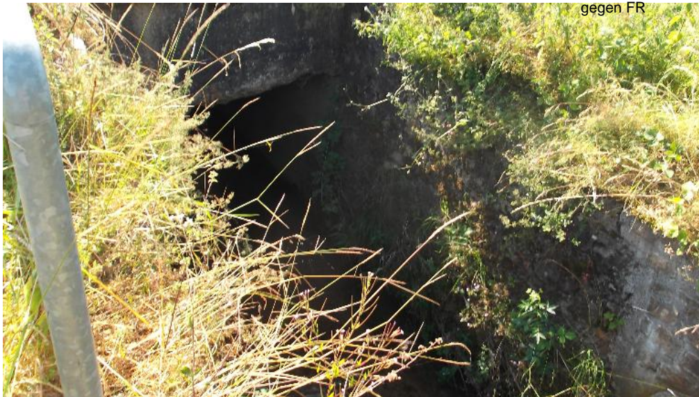
Durchlass; Lauf verengt
