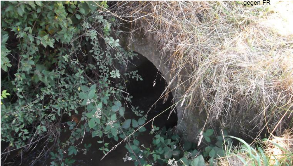
Durchlass; Lauf verengt
