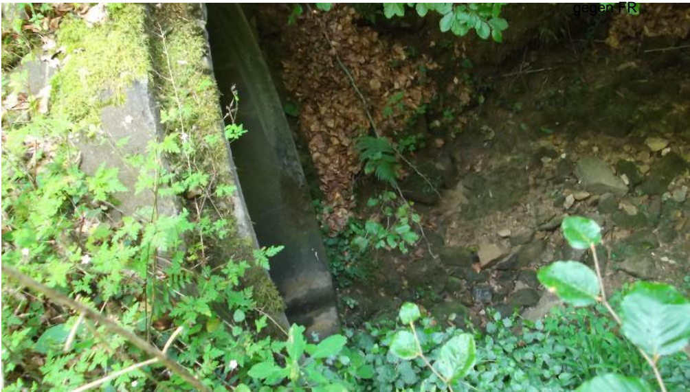
Durchlass; Lauf verengt
