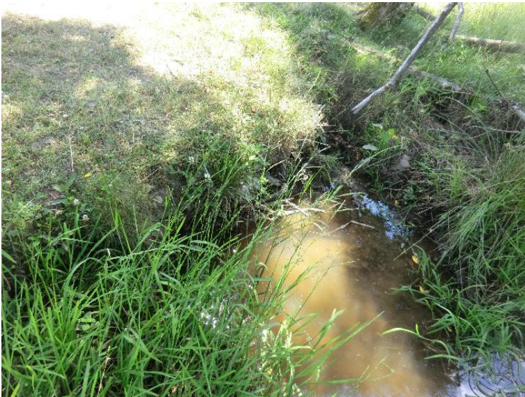
Durchlass; Ufer unterbrochen - Durchlass; Lauf verengt
