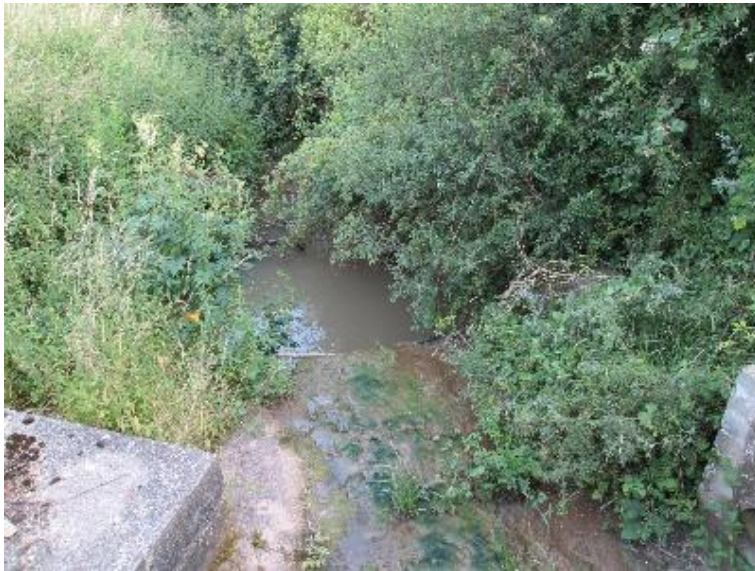
Absturz aus Verrohrung
