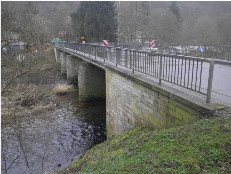
Durchlass; Ufer unterbrochen
