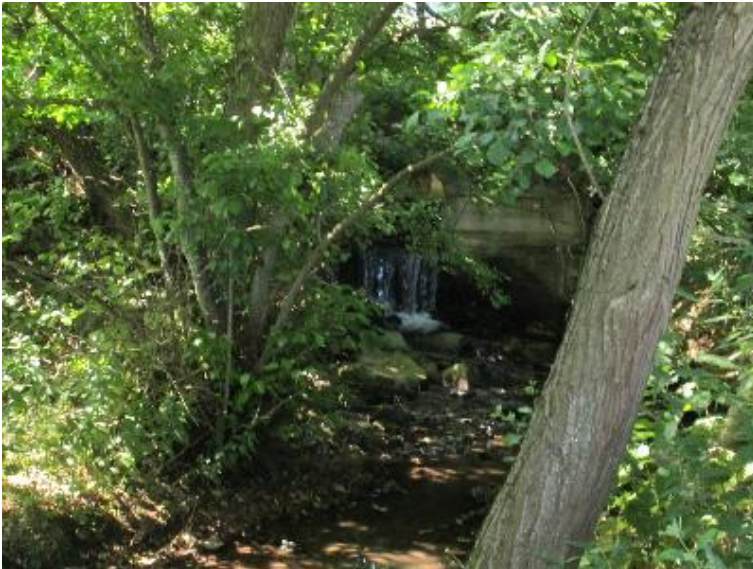
Absturz aus Verrohrung
