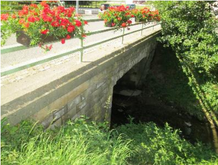
Durchlass; Ufer unterbrochen
