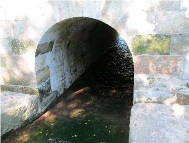
Durchlass; Ufer unterbrochen
