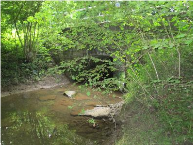
Durchlass; Ufer unterbrochen
