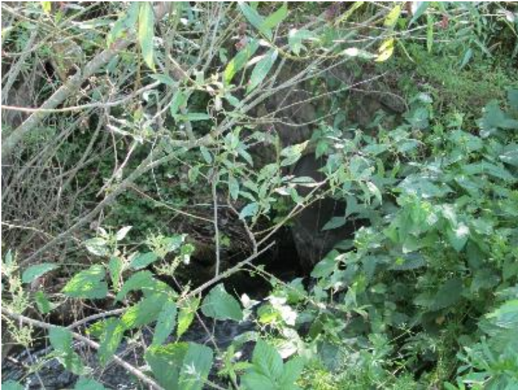
Absturz aus Verrohrung
