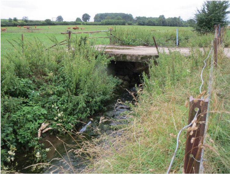
Durchlass; Ufer unterbrochen
