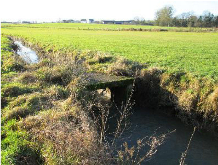
Durchlass; Ufer unterbrochen
